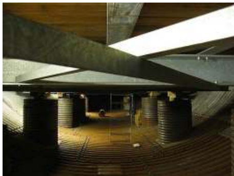
Rysunek 5.12: Ruszt dla kontenerów mieszkalnych wewnątrz tunelu podlodowego na stacji Neumayer (Alfred Weneger Institut)
